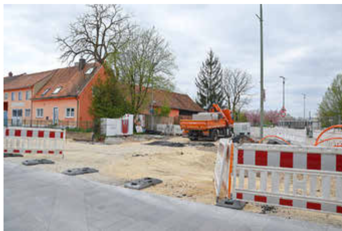
Eine der beiden letzten Teilflächen, die noch gepflastert werden müssen: die Zufahrt zur Haltestelle „Königsbrunn Zentrum“.
